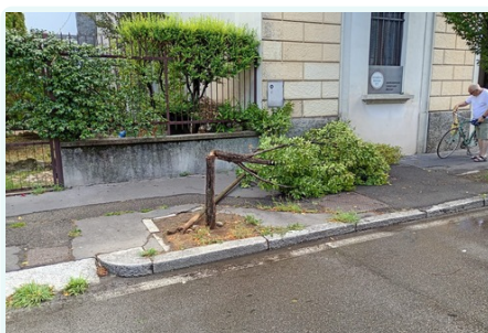
Verde non curato e strutture ammalorate
